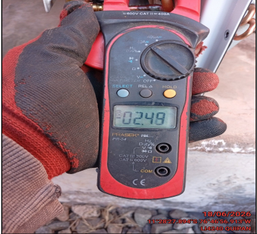
FOTO CORRIENTE REAL EN COMPRESOR
