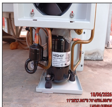
FOTO DE COMPRESOR
