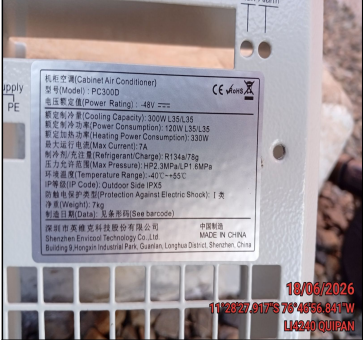
FOTO CORRIENTE SEGUN PLACA COMPRESOR
