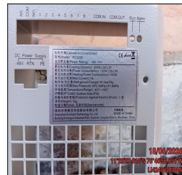
FOTO DE PLACA DE UNIDAD CONDENSADORA
