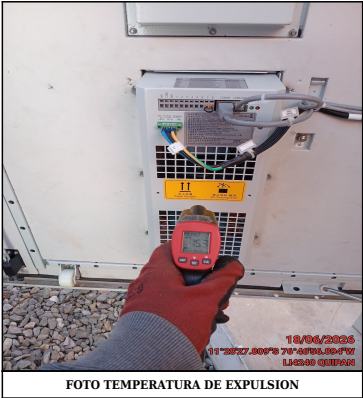
FOTO TEMPERATURA DE EXPULSION
