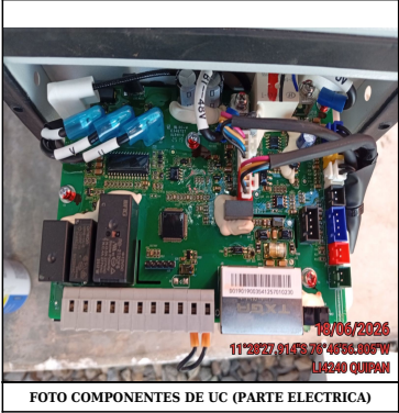
FOTO COMPONENTES DE UC (PARTE ELECTRICA)
