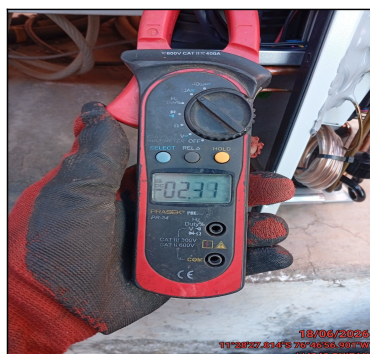
FOTO CORRIENTE REAL EN MOTOR VENTILADOR
