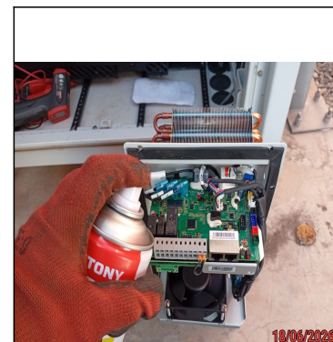
FOTO DE COMPONENTES DE UE (PARTE ELECTRICA)
