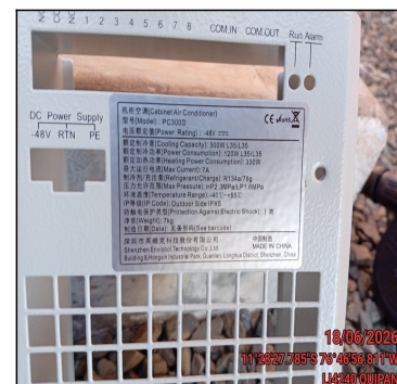
FOTO CORRIENTE SEGUN PLACA EN MOTOR VENTILADOR
