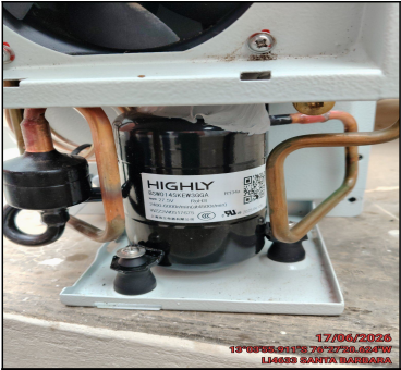
FOTO CORRIENTE REAL EN COMPRESOR
