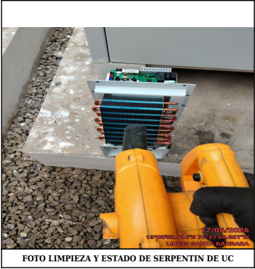
FOTO LIMPIEZA Y ESTADO DE SERPENTIN DE UC
