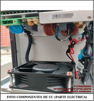
FOTO COMPONENTES DE UC (PARTE ELECTRICA)
