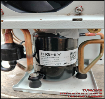
FOTO CORRIENTE SEGUN PLACA COMPRESOR
