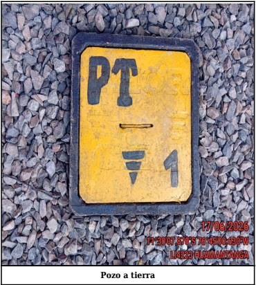
Pozo a tierra
