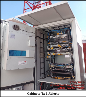
Gabinete Tx 1 Abierto
