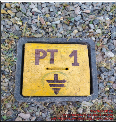
Pozo a tierra
