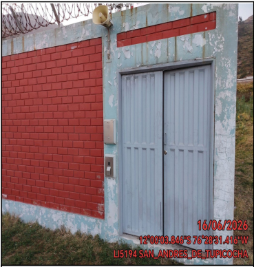
Pozo a tierra
