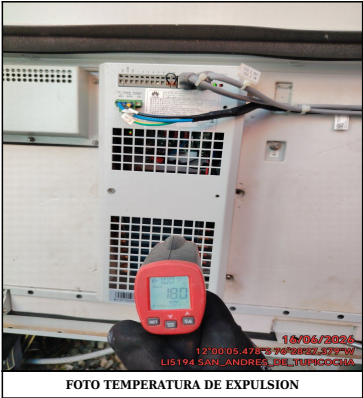
FOTO TEMPERATURA DE EXPULSION
