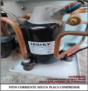
FOTO CORRIENTE SEGUN PLACA COMPRESOR
