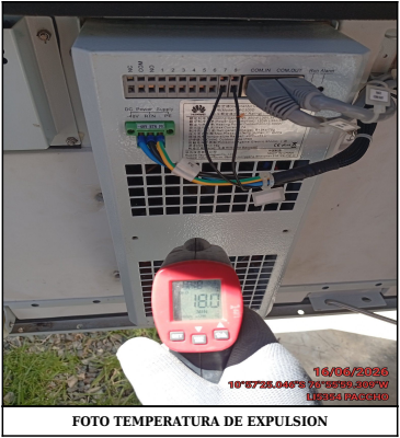
FOTO TEMPERATURA DE EXPULSION
