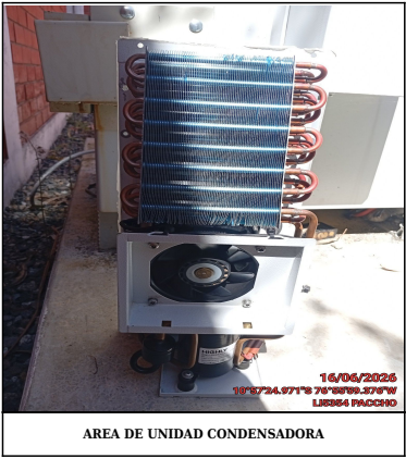
AREA DE UNIDAD CONDENSADORA
