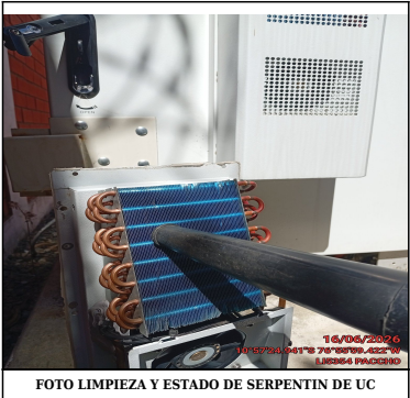
FOTO LIMPIEZA Y ESTADO DE SERPENTIN DE UC
