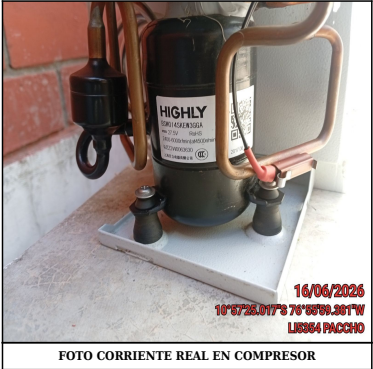
FOTO CORRIENTE REAL EN COMPRESOR
