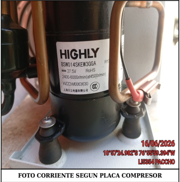
FOTO CORRIENTE SEGUN PLACA COMPRESOR
