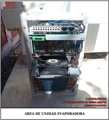
AREA DE UNIDAD EVAPORADORA
