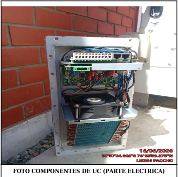
FOTO COMPONENTES DE UC (PARTE ELECTRICA)
