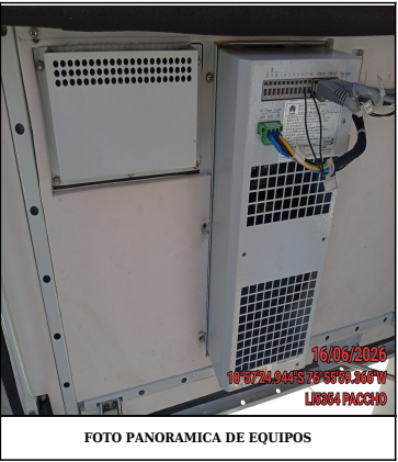
FOTO PANORAMICA DE EQUIPOS
