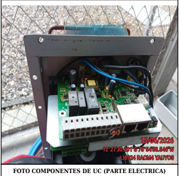
FOTO COMPONENTES DE UC (PARTE ELECTRICA)
