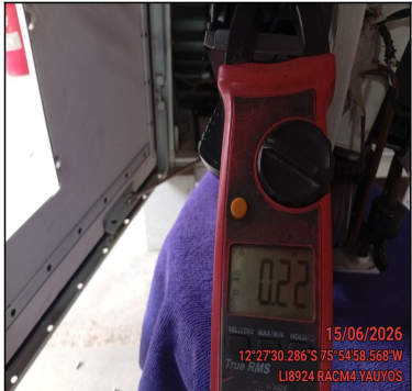
FOTO CORRIENTE REAL EN MOTOR VENTILADOR
