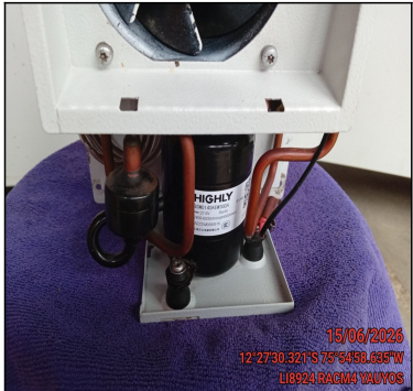
FOTO DE COMPRESOR
