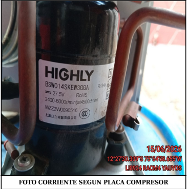
FOTO CORRIENTE SEGUN PLACA COMPRESOR
