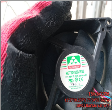
FOTO CORRIENTE SEGUN PLACA EN MOTOR VENTILADOR
