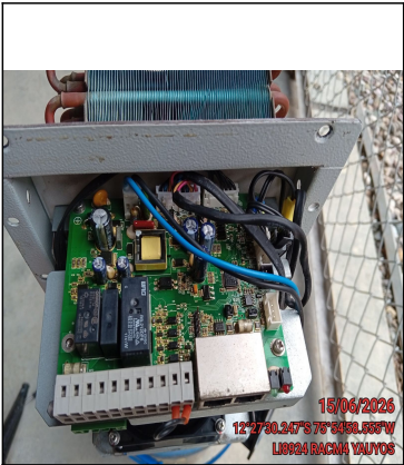
FOTO DE COMPONENTES DE UE (PARTE ELECTRICA)
