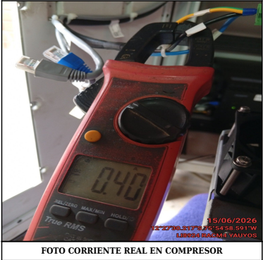
FOTO CORRIENTE REAL EN COMPRESOR
