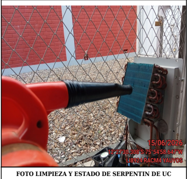
FOTO LIMPIEZA Y ESTADO DE SERPENTIN DE UC
