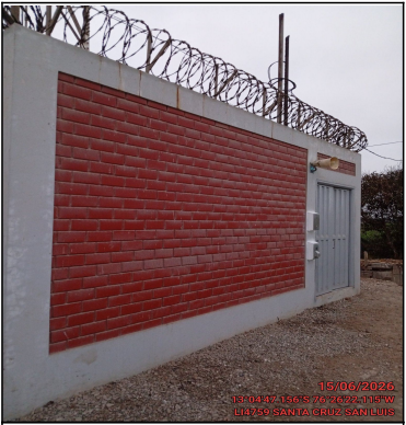
Pozo a tierra
