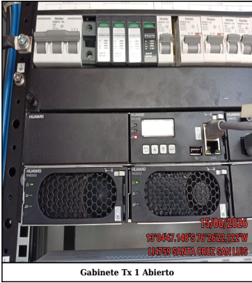
Gabinete Tx 1 Abierto
