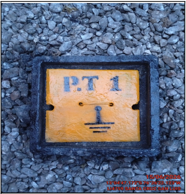
Pozo a tierra
