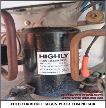
FOTO CORRIENTE SEGUN PLACA COMPRESOR
