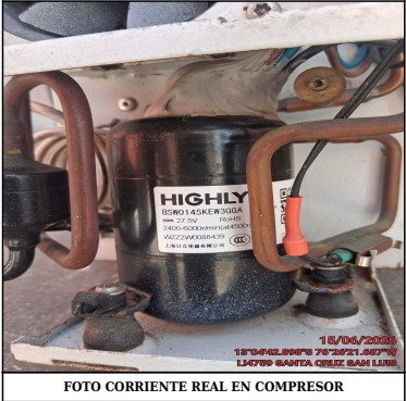
FOTO CORRIENTE REAL EN COMPRESOR
