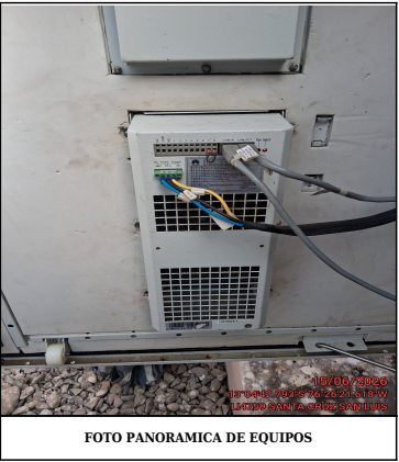
FOTO PANORAMICA DE EQUIPOS
