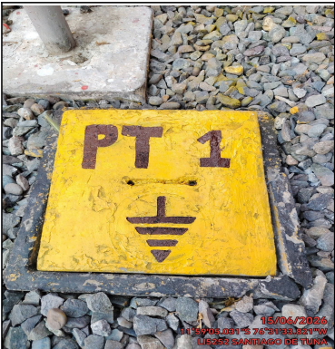
Pozo a tierra
