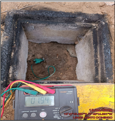
Pozo a tierra
