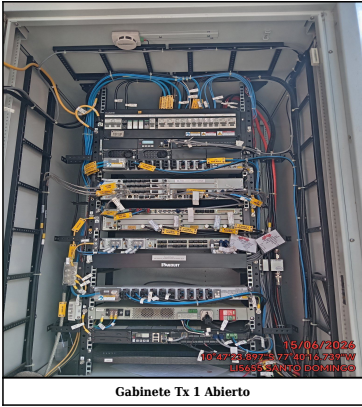
Gabinete Tx 1 Abierto
