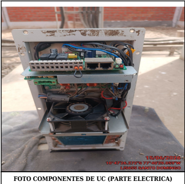
FOTO COMPONENTES DE UC (PARTE ELECTRICA)
