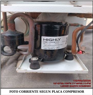
FOTO CORRIENTE SEGUN PLACA COMPRESOR
