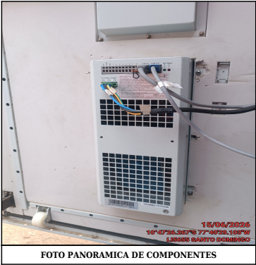
FOTO PANORAMICA DE COMPONENTES
