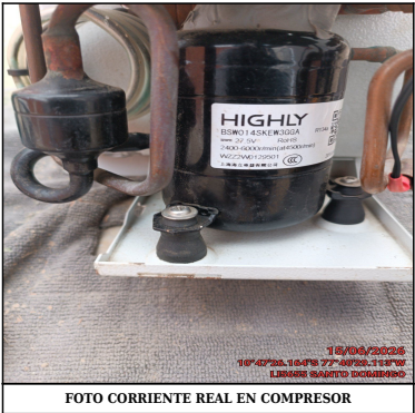
FOTO CORRIENTE REAL EN COMPRESOR
