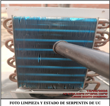
FOTO LIMPIEZA Y ESTADO DE SERPENTIN DE UC
