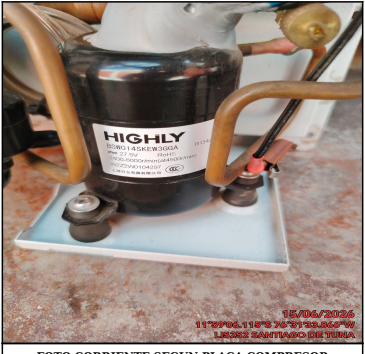
FOTO CORRIENTE SEGUN PLACA COMPRESOR
