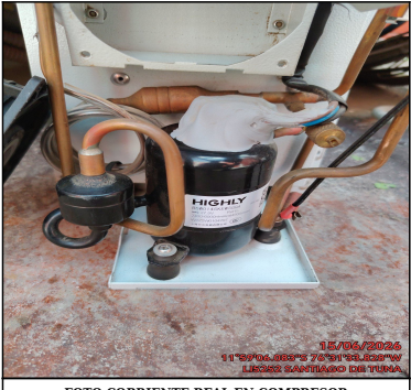
FOTO CORRIENTE REAL EN COMPRESOR
