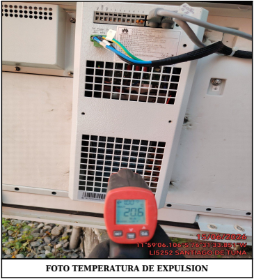
FOTO TEMPERATURA DE EXPULSION
