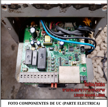
FOTO COMPONENTES DE UC (PARTE ELECTRICA)
