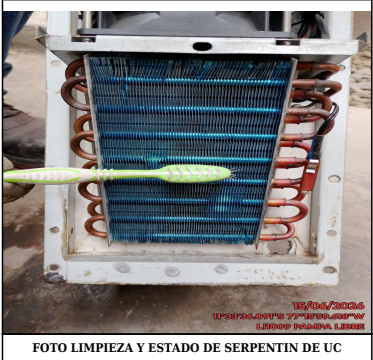
FOTO LIMPIEZA Y ESTADO DE SERPENTIN DE UC
