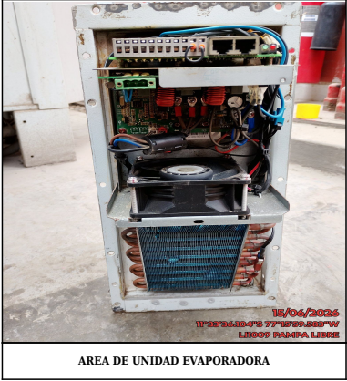
AREA DE UNIDAD EVAPORADORA
