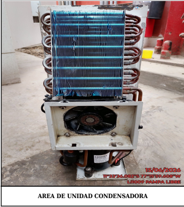
AREA DE UNIDAD CONDENSADORA
