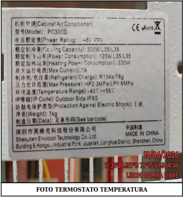
FOTO TERMOSTATO TEMPERATURA
