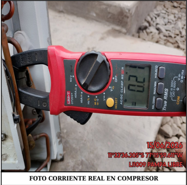
FOTO CORRIENTE REAL EN COMPRESOR
