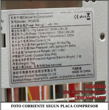
FOTO CORRIENTE SEGUN PLACA COMPRESOR
