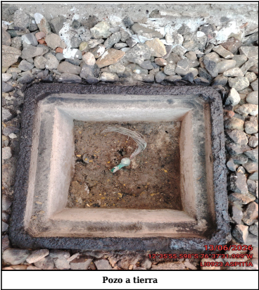
Pozo a tierra
