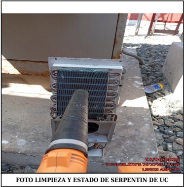
FOTO LIMPIEZA Y ESTADO DE SERPENTIN DE UC
