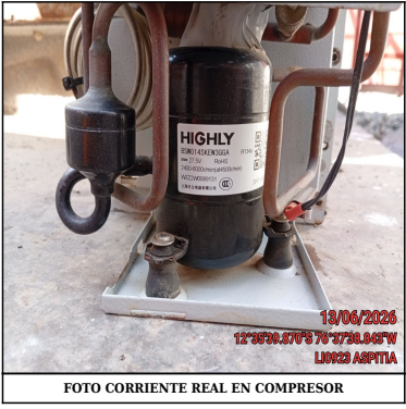
FOTO CORRIENTE REAL EN COMPRESOR
