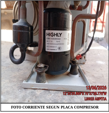
FOTO CORRIENTE SEGUN PLACA COMPRESOR
