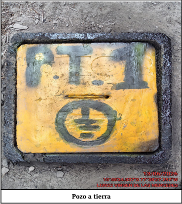
Pozo a tierra
