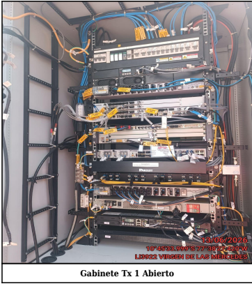
Gabinete Tx 1 Abierto
