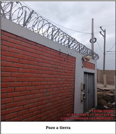
Pozo a tierra
