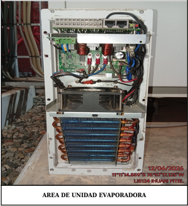
AREA DE UNIDAD EVAPORADORA
