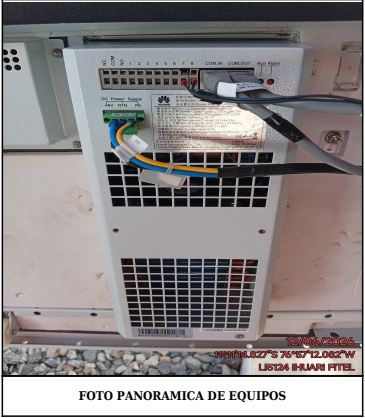
FOTO PANORAMICA DE EQUIPOS
