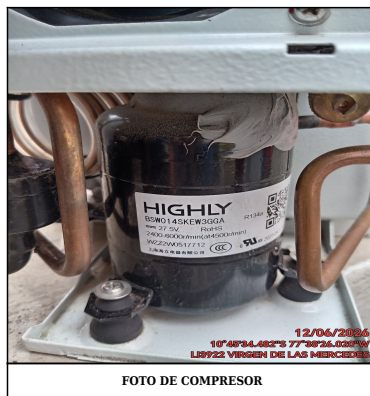
FOTO DE COMPRESOR
