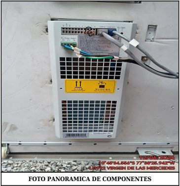
FOTO PANORAMICA DE COMPONENTES
