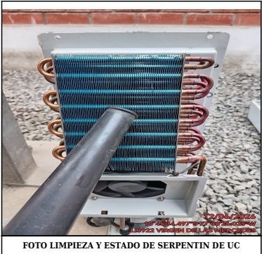
FOTO LIMPIEZA Y ESTADO DE SERPENTIN DE UC
