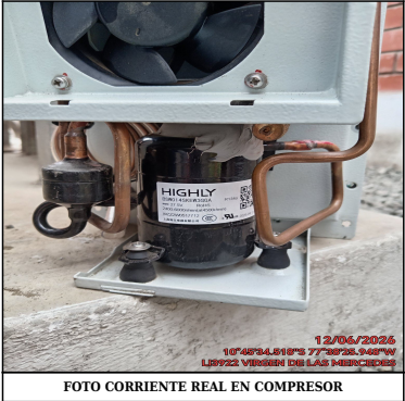
FOTO CORRIENTE REAL EN COMPRESOR
