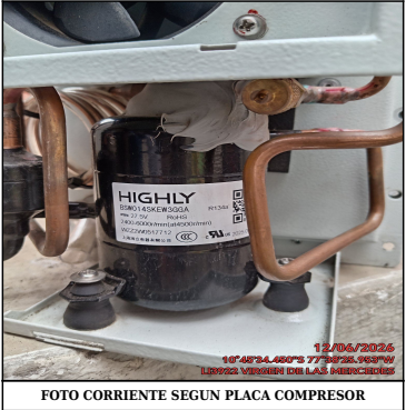
FOTO CORRIENTE SEGUN PLACA COMPRESOR
