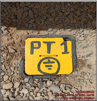
Pozo a tierra
