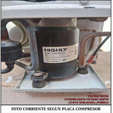
FOTO CORRIENTE SEGUN PLACA COMPRESOR
