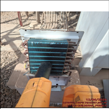
FOTO LIMPIEZA Y ESTADO DE SERPENTIN DE UC
