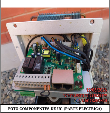
FOTO COMPONENTES DE UC (PARTE ELECTRICA)
