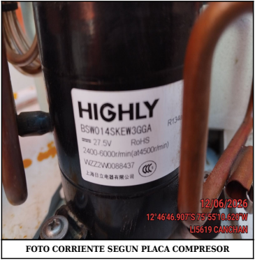
FOTO CORRIENTE SEGUN PLACA COMPRESOR
