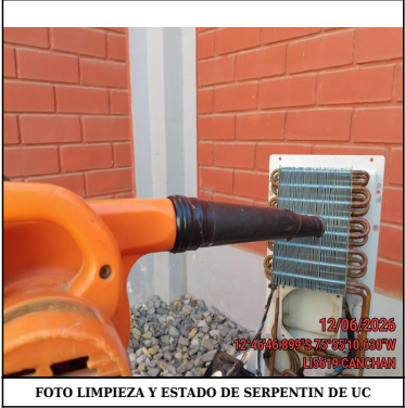
FOTO LIMPIEZA Y ESTADO DE SERPENTIN DE UC
