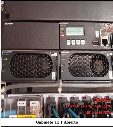
Gabinete Tx 1 Abierto
