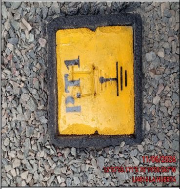
Pozo a tierra
