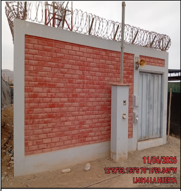
Pozo a tierra
