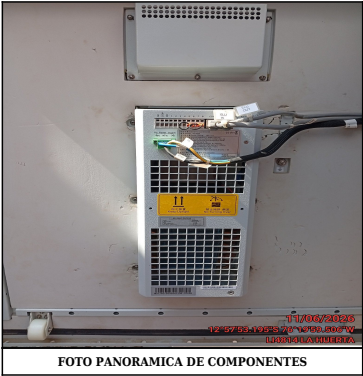
FOTO PANORAMICA DE COMPONENTES
