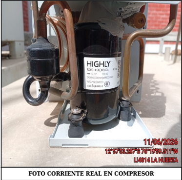
FOTO CORRIENTE REAL EN COMPRESOR
