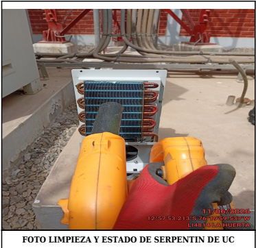
FOTO LIMPIEZA Y ESTADO DE SERPENTIN DE UC
