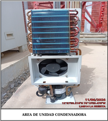
AREA DE UNIDAD CONDENSADORA
