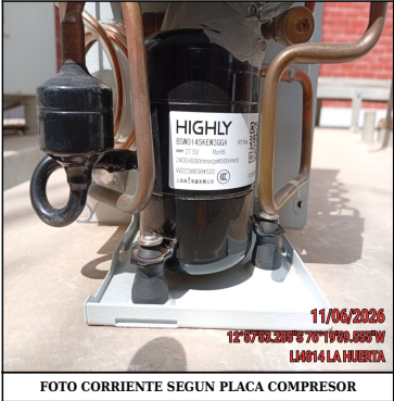
FOTO CORRIENTE SEGUN PLACA COMPRESOR
