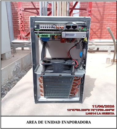
AREA DE UNIDAD EVAPORADORA
