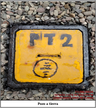
Pozo a tierra
