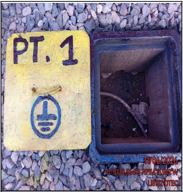
Pozo a tierra
