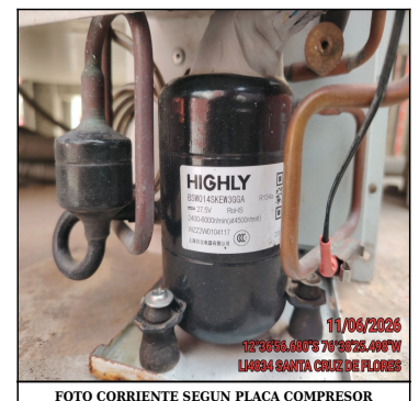
FOTO CORRIENTE SEGUN PLACA COMPRESOR
