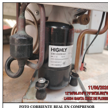
FOTO CORRIENTE REAL EN COMPRESOR
