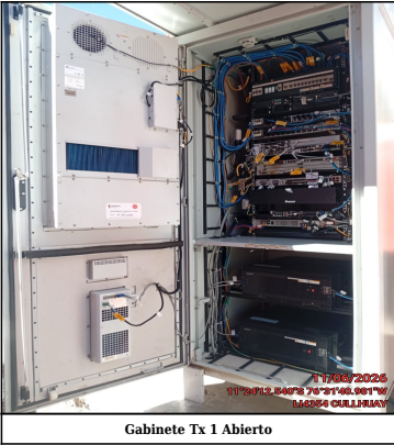
Gabinete Tx 1 Abierto
