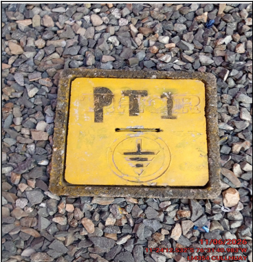
Pozo a tierra
