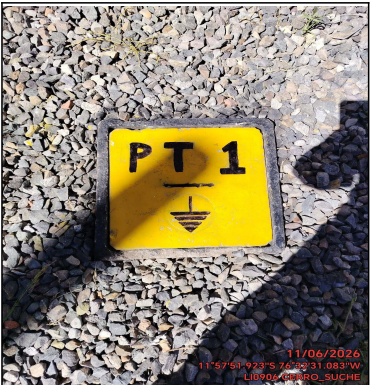
Pozo a tierra
