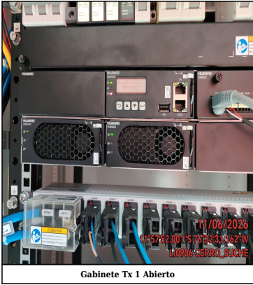
Gabinete Tx 1 Abierto
