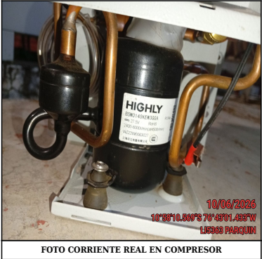
FOTO CORRIENTE REAL EN COMPRESOR
