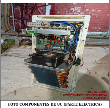
FOTO COMPONENTES DE UC (PARTE ELECTRICA)
