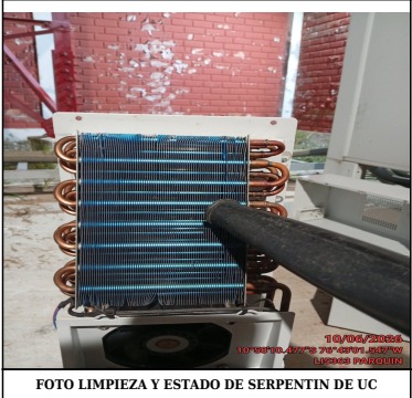
FOTO LIMPIEZA Y ESTADO DE SERPENTIN DE UC
