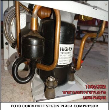
FOTO CORRIENTE SEGUN PLACA COMPRESOR
