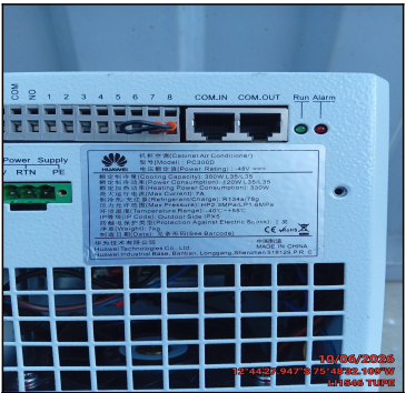
FOTO DE PLACA DE UNIDAD CONDENSADORA
