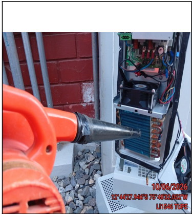
FOTO DE LIMPIEZA Y ESTADO DE SERPENTIN DE UE
