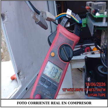
FOTO CORRIENTE REAL EN COMPRESOR
