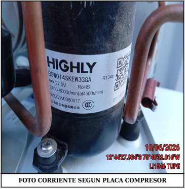
FOTO CORRIENTE SEGUN PLACA COMPRESOR
