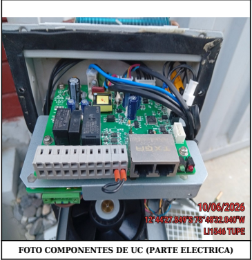
FOTO COMPONENTES DE UC (PARTE ELECTRICA)
