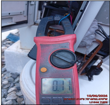
FOTO CORRIENTE REAL EN MOTOR VENTILADOR
