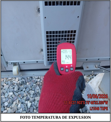
FOTO TEMPERATURA DE EXPULSION
