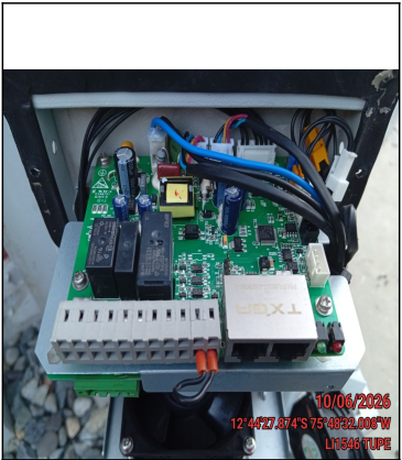
FOTO DE COMPONENTES DE UE (PARTE ELECTRICA)
