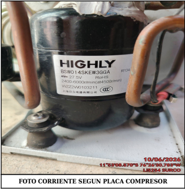
FOTO CORRIENTE SEGUN PLACA COMPRESOR
