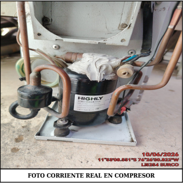
FOTO CORRIENTE REAL EN COMPRESOR
