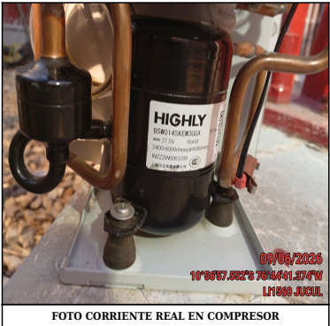
FOTO CORRIENTE REAL EN COMPRESOR
