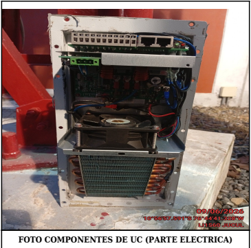
FOTO COMPONENTES DE UC (PARTE ELECTRICA)
