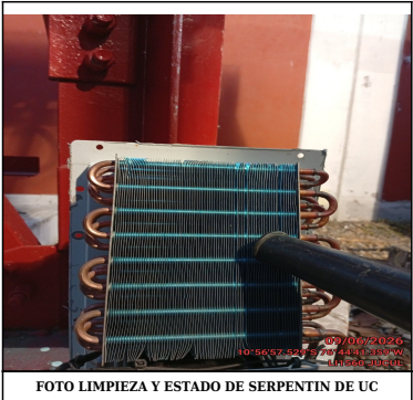
FOTO LIMPIEZA Y ESTADO DE SERPENTIN DE UC
