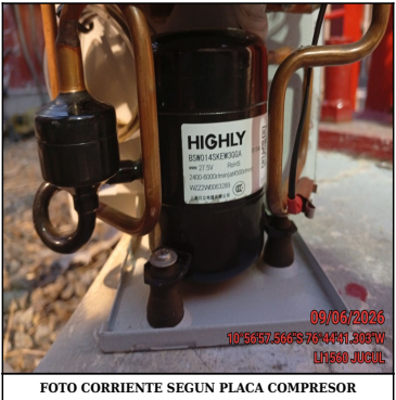
FOTO CORRIENTE SEGUN PLACA COMPRESOR
