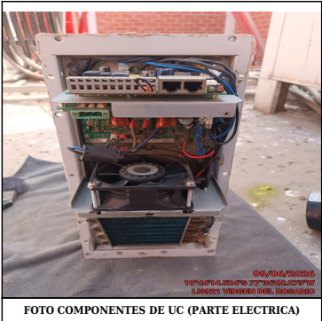
FOTO COMPONENTES DE UC (PARTE ELECTRICA)
