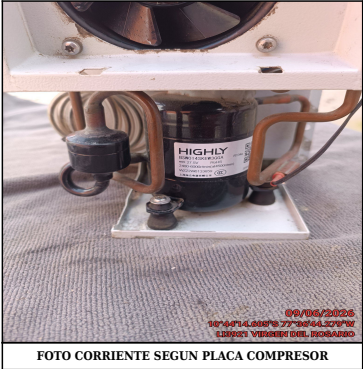
FOTO CORRIENTE SEGUN PLACA COMPRESOR
