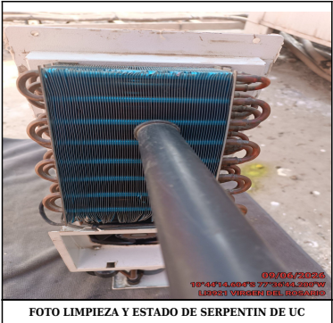
FOTO LIMPIEZA Y ESTADO DE SERPENTIN DE UC
