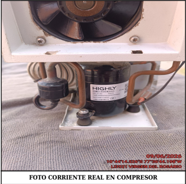
FOTO CORRIENTE REAL EN COMPRESOR
