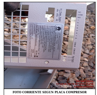
FOTO CORRIENTE SEGUN PLACA COMPRESOR
