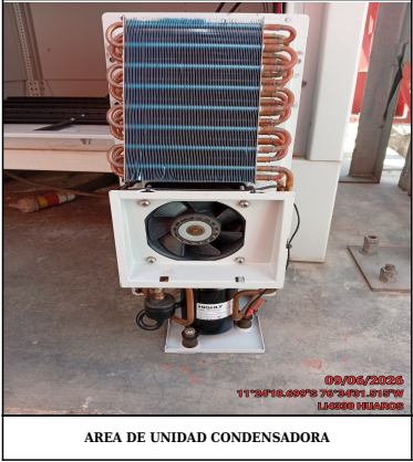
AREA DE UNIDAD CONDENSADORA
