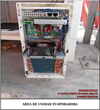
AREA DE UNIDAD EVAPORADORA
