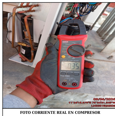
FOTO CORRIENTE REAL EN COMPRESOR
