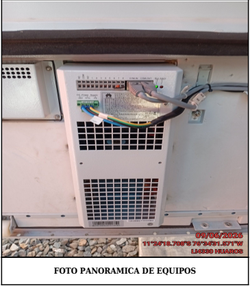
FOTO PANORAMICA DE EQUIPOS
