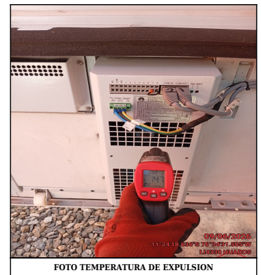
FOTO TEMPERATURA DE EXPULSION
