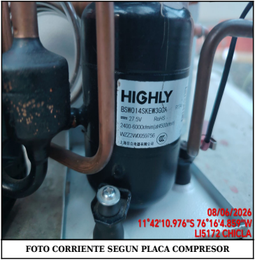
FOTO CORRIENTE SEGUN PLACA COMPRESOR
