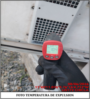
FOTO TEMPERATURA DE EXPULSION
