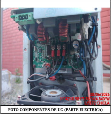
FOTO COMPONENTES DE UC (PARTE ELECTRICA)
