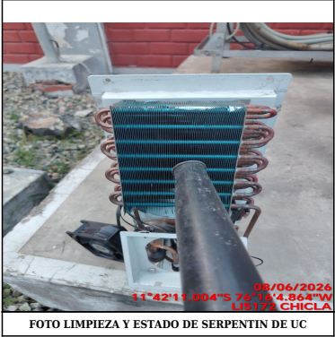
FOTO LIMPIEZA Y ESTADO DE SERPENTIN DE UC
