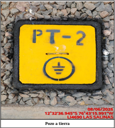
Pozo a tierra
