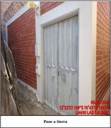
Pozo a tierra
