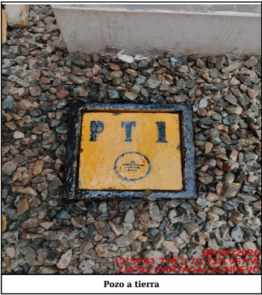
Pozo a tierra
