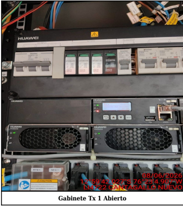
Gabinete Tx 1 Abierto
