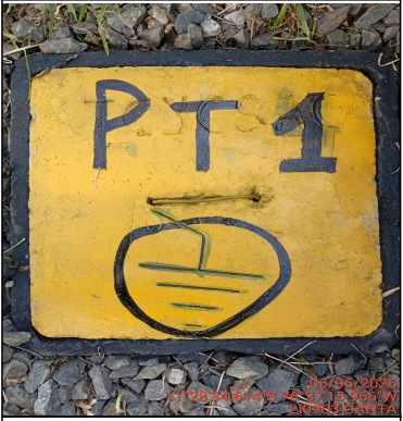
Pozo a tierra
