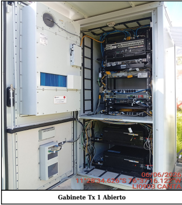
Gabinete Tx 1 Abierto
