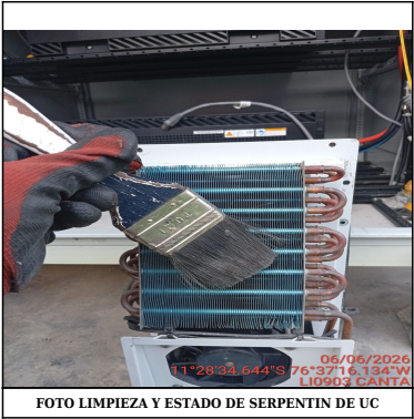
FOTO LIMPIEZA Y ESTADO DE SERPENTIN DE UC
