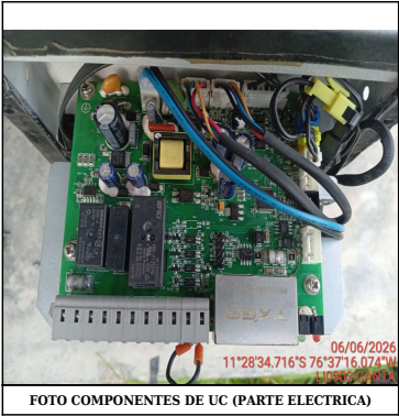
FOTO COMPONENTES DE UC (PARTE ELECTRICA)
