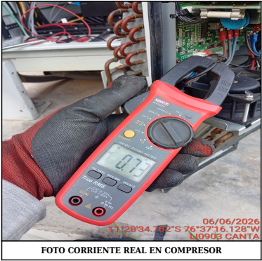
FOTO CORRIENTE REAL EN COMPRESOR
