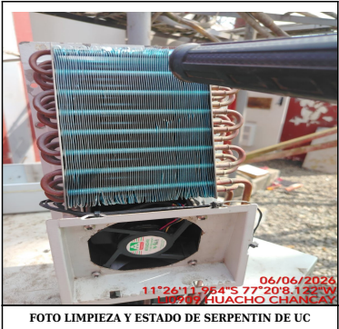
FOTO LIMPIEZA Y ESTADO DE SERPENTIN DE UC
