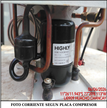
FOTO CORRIENTE SEGUN PLACA COMPRESOR
