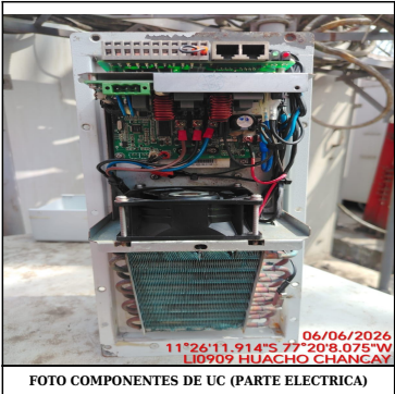
FOTO COMPONENTES DE UC (PARTE ELECTRICA)
