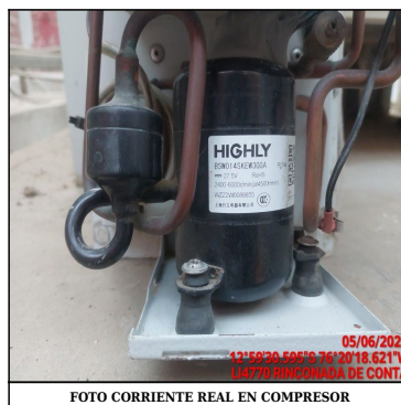
FOTO CORRIENTE REAL EN COMPRESOR
