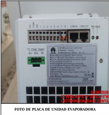
FOTO DE PLACA DE UNIDAD EVAPORADORA
