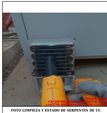
FOTO LIMPIEZA Y ESTADO DE SERPENTIN DE UC
