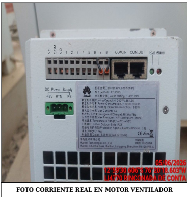
FOTO CORRIENTE REAL EN MOTOR VENTILADOR
