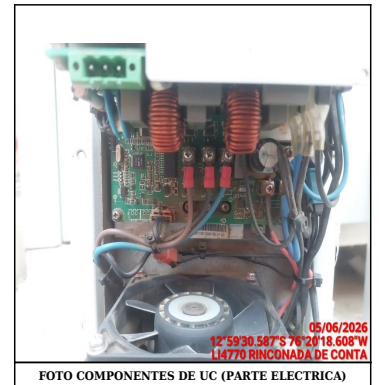
FOTO COMPONENTES DE UC (PARTE ELECTRICA)
