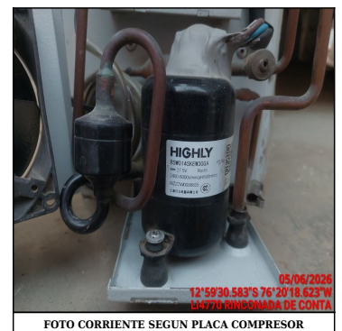
FOTO CORRIENTE SEGUN PLACA COMPRESOR
