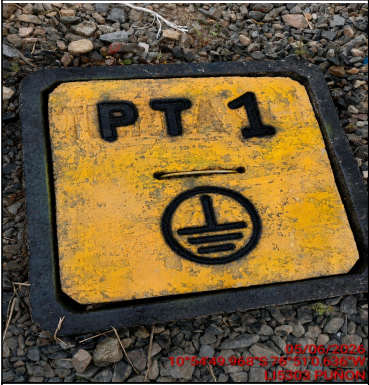
Pozo a tierra
