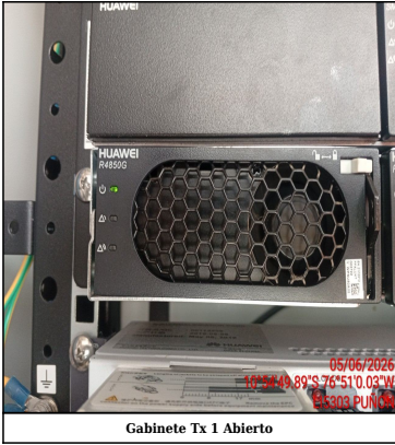
Gabinete Tx 1 Abierto
