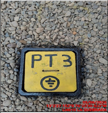
Pozo a tierra
