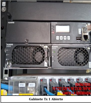
Gabinete Tx 1 Abierto
