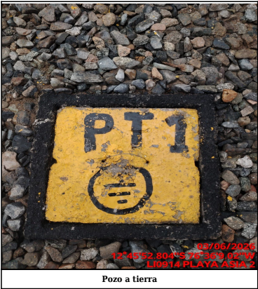
Pozo a tierra
