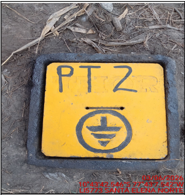
Pozo a tierra
