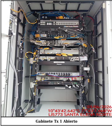
Gabinete Tx 1 Abierto
