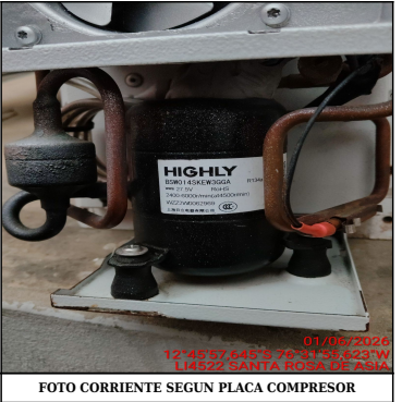
FOTO CORRIENTE SEGUN PLACA COMPRESOR
