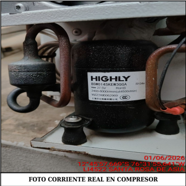
FOTO CORRIENTE REAL EN COMPRESOR
