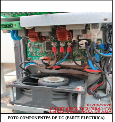
FOTO COMPONENTES DE UC (PARTE ELECTRICA)
