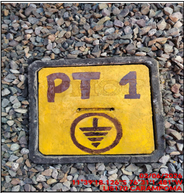
Pozo a tierra
