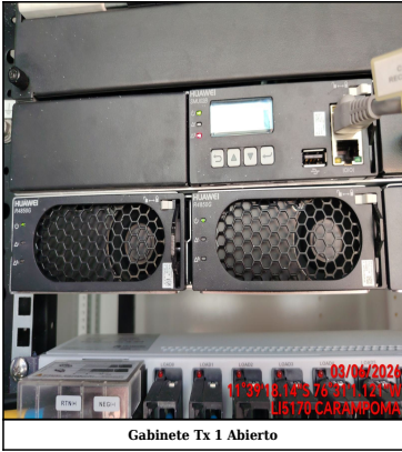
Gabinete Tx 1 Abierto
