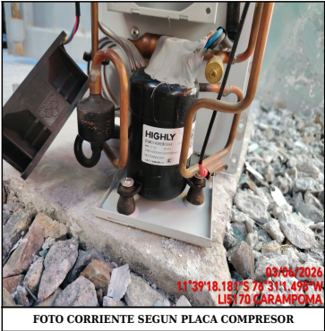
FOTO CORRIENTE SEGUN PLACA COMPRESOR
