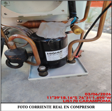
FOTO CORRIENTE REAL EN COMPRESOR
