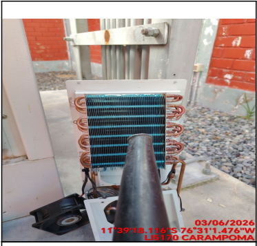
FOTO LIMPIEZA Y ESTADO DE SERPENTIN DE UC
