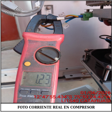
FOTO CORRIENTE REAL EN COMPRESOR
