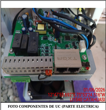
FOTO COMPONENTES DE UC (PARTE ELECTRICA)
