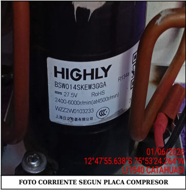
FOTO CORRIENTE SEGUN PLACA COMPRESOR
