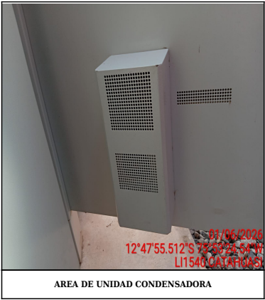
AREA DE UNIDAD CONDENSADORA
