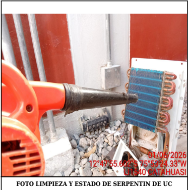
FOTO LIMPIEZA Y ESTADO DE SERPENTIN DE UC
