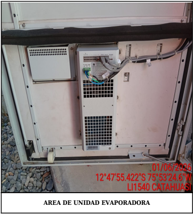
AREA DE UNIDAD EVAPORADORA
